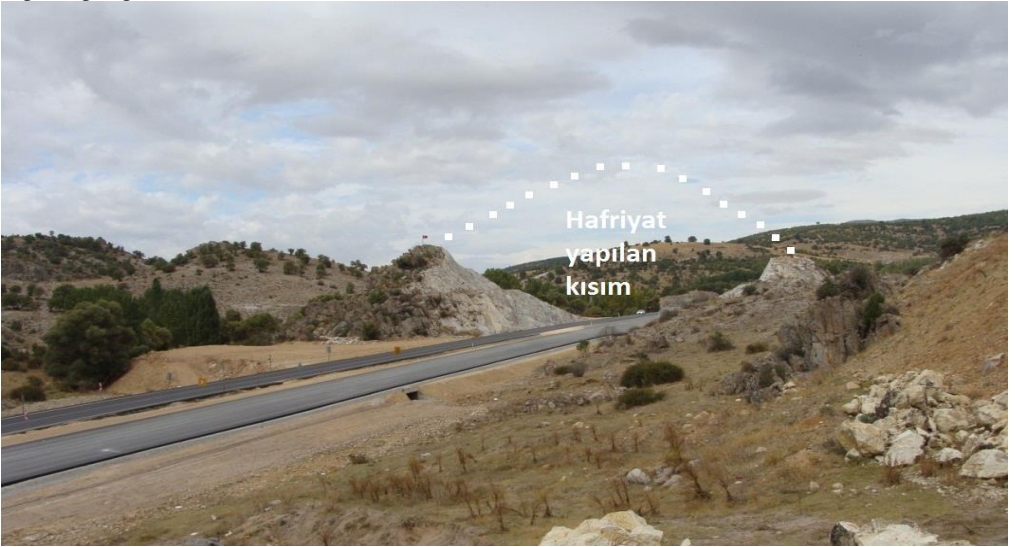
Foto 11. Bağırsak Boğazı'nda yapılan hafriyatın boyutunu yansıtan örneklerden biri. Yol çalışmalarında boğazın doğal görünümünde önemli değişiklikler meydana gelmiştir.
