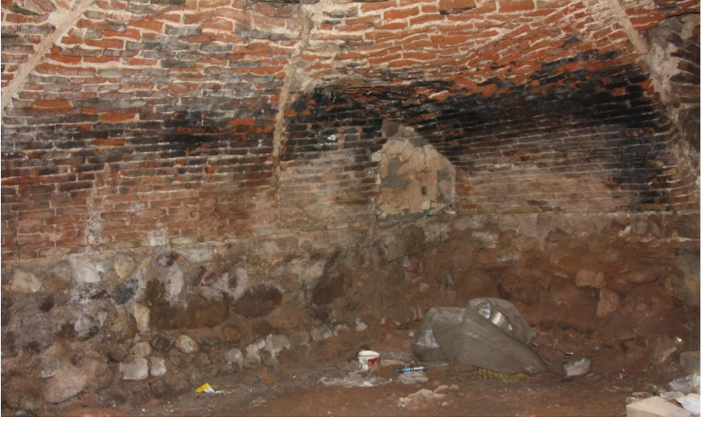
Fotoğraf 12: Çaput Baba Türbesi İç Mekan Güneybatıdan Görünüş
